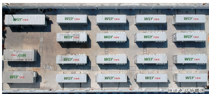
恒运电站俯瞰图
